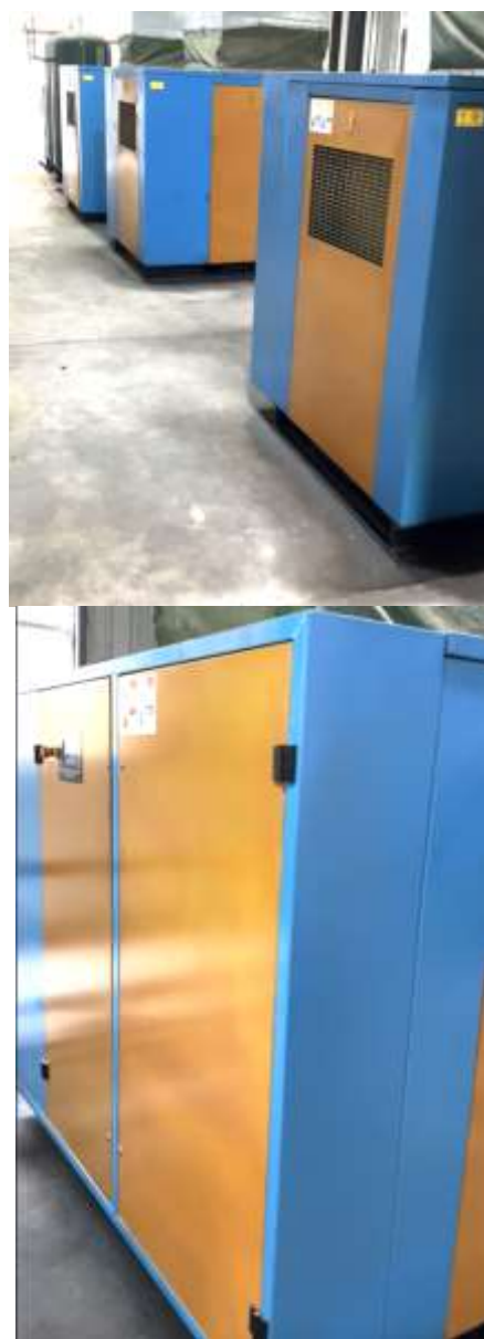
4 台 55kW 永磁電機及變頻功能的節能螺桿空氣壓縮機
